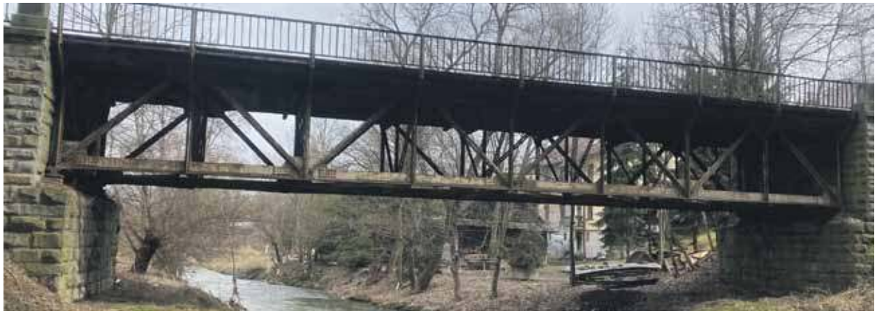
Rozpadający się stary most na Rabie - w ciągu głównej drogi dojazdowej do Skansenu Taboru Kolejowego.
