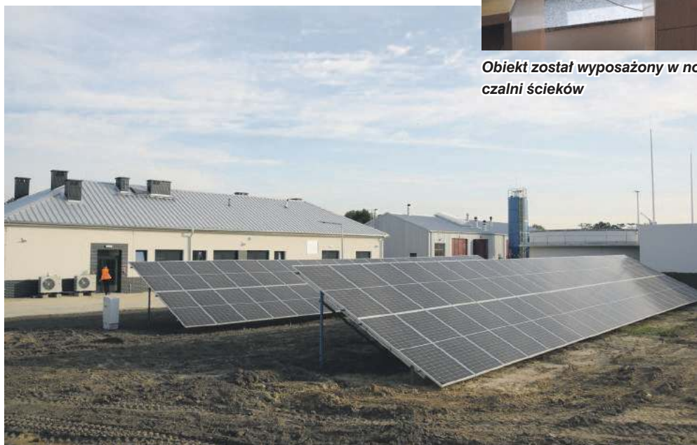
Oczyszczalnia ścieków w Strzeszowie to nowoczesny obiekt wyposażony również w panele fotowoltaiczne produkujące prąd na potrzeby tego obiektu
