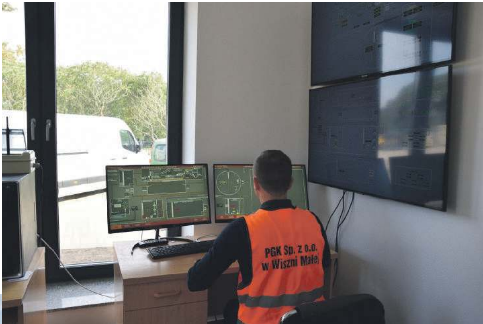
Obiekt został wyposażony w nowoczesne urządzenia oraz automatykę do sterowania pracą oczyszczalni ścieków
