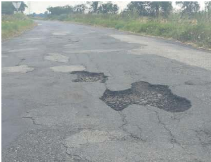
Fragment drogi powiatowej z Białobrzezia w kierunku Kondratowic. W tym momencie remont niewiele pomoże. Konieczna będzie gruntowna przebudowa
