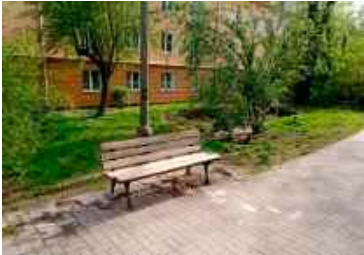
Rozpadający się chodnik na skwerku ma być niebawem naprawiony
