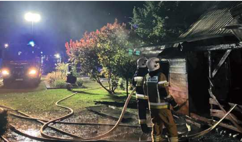
Akcja ratunkowa trwała kilka godzin. Konieczna była częściowa rozbiórka konstrukcji dachu w celu dogaszenia zarzewia ognia
