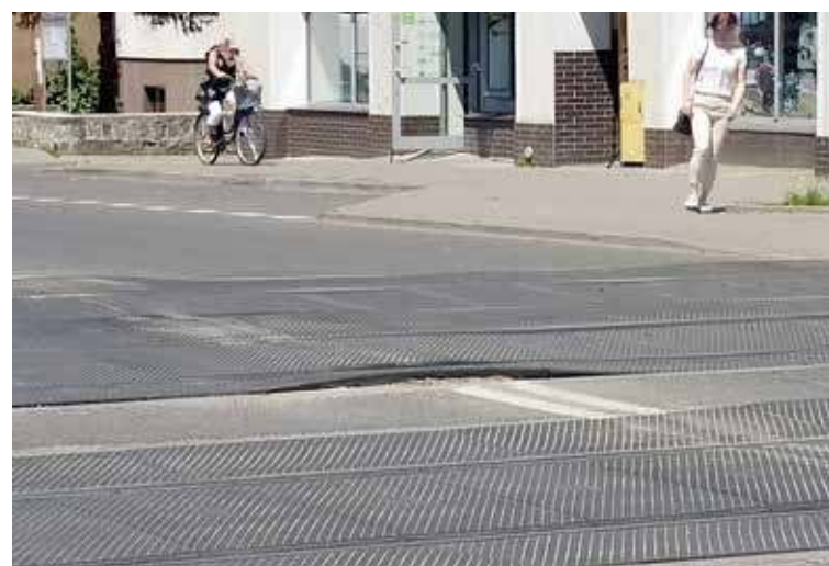
Nawierzchnia przejazdu kolejowego w wielu miejscach się odkształca, co nie mogło ująć uwagę kierowców
