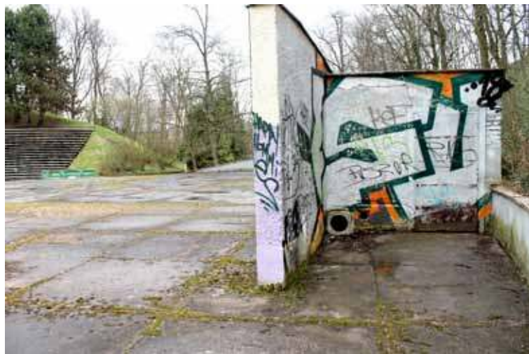
Wielu mieszkańców mówi, że to wstyd, że tak ważny obiekt znajduje się w opłakanym stanie
