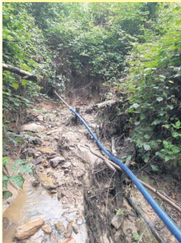
Rurociąg doprowadzający wodę do kilku domów w Miłoticach przebiega przez wawóz
