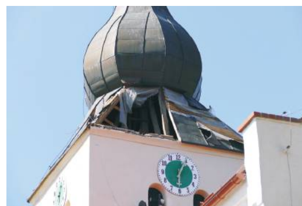
W Witowicach nawałnica zniszczyła kopułę wieży kościelnej
