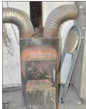
Podgrzewanie na metalowym piecu puszki z zawartością rozcieńczalnika w sprayu skończyło się tragedią. Pomimo prowadzonej reanimacji, życia mężczyzny nie udało się uratować
