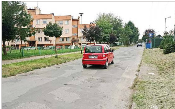
Ul. Brzegowa od wielu lat czeka na remont. Obecnie to łąka na łacie.
