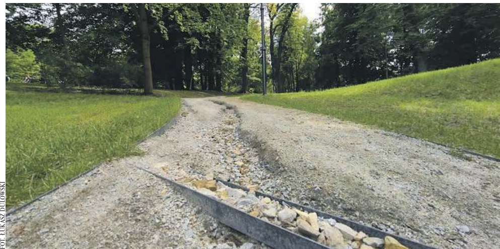
Zniszczone alejki w kościelckim parku
