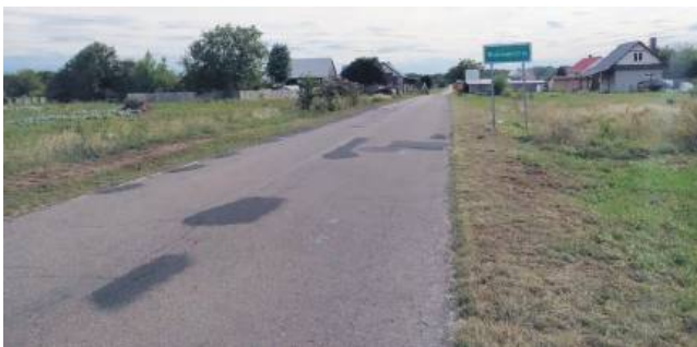
Droga na kilkukilometrowym odcinku jest w złym stanie.
