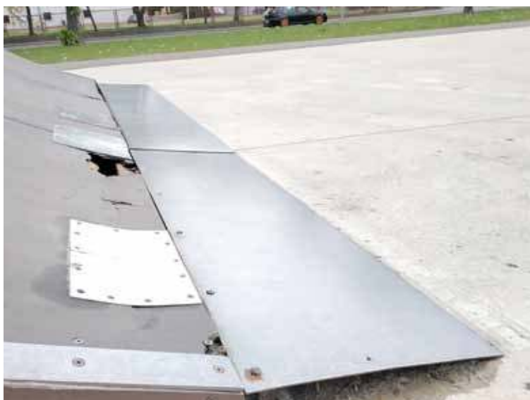
Miejscami widać nawet wystające gwoździe
