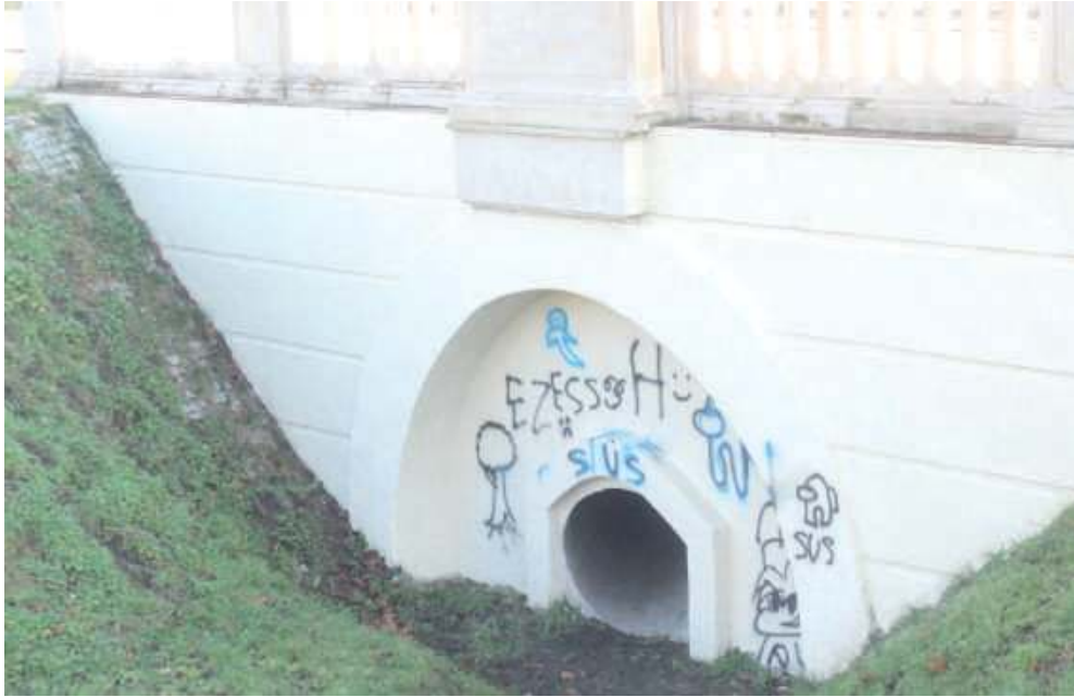
Nowy most przy głównym wejściu do zespołu zamkowo-parkowego został oszpecony mazajami wandal
