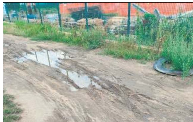
Mieszkańcy skarżą się na stan drogi między stacją energetyczną a działkami.
