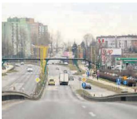
Nawierzchnia gierkówki w Częstochowie składa się z niezliczonej ilości łat
