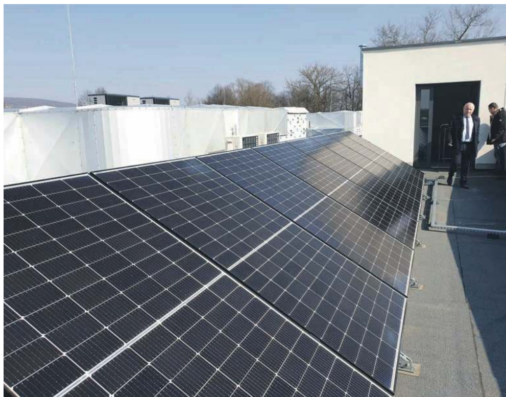
Niemal na całym dachu nowego budynku znajdują się panele fotowoltaiczne
