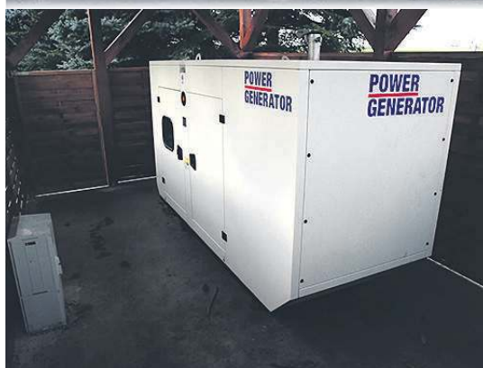
Agregat prądotwórczy pozwoli zasilć przedszkole i szkołę na wypadek awarii.
