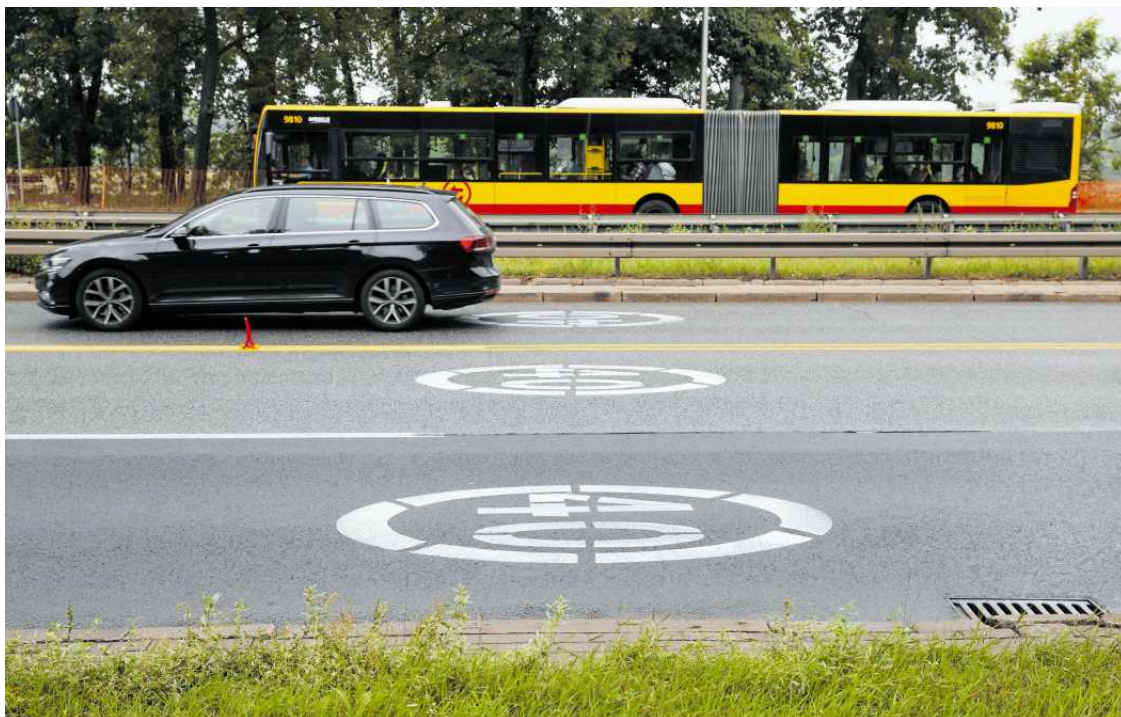
• Remont Wisłostrady. Po wypadku na jezdni z kontraruchem ustawiono małe odblaskowe słupki i wymalowano znaki przypominające o ograniczeniu prędkości do 40 km na godz.
