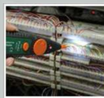
podświetlenie miejsca pracy
