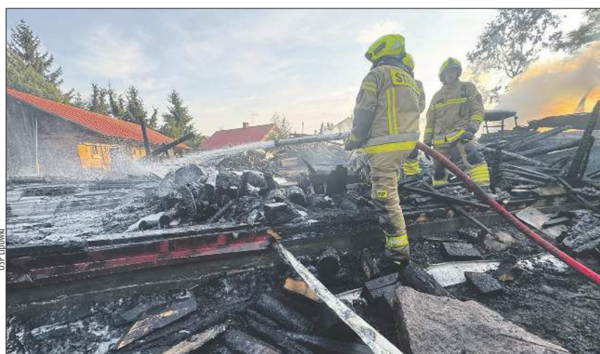
■ Strażacy podali pięć prądów wody, w tym jeden w obronie zagrożonego budynku mieszkalnego
