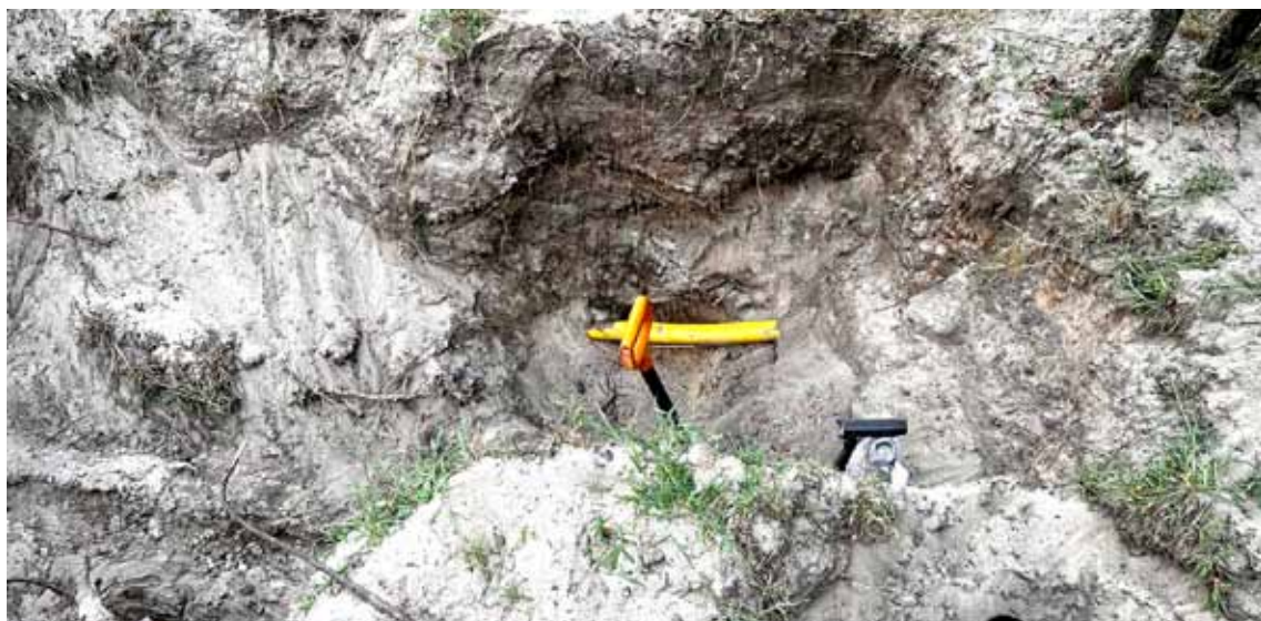
W miniony poniedziałek strażacy odebrali zgłoszenie o rozszczelnionej rurze w miejscowości Niedźwiedź. Foto. OSP. Kobylanka
