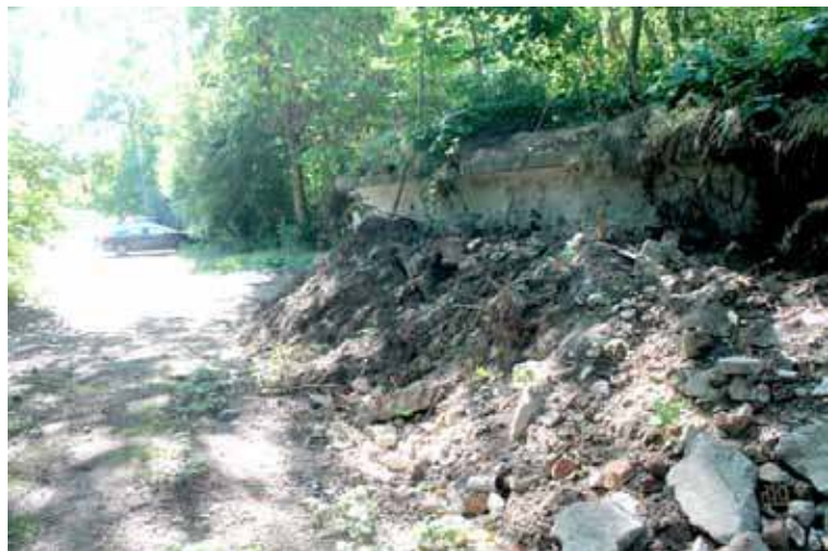
Niezabezpieczone wejścia do budowli stwarzały zagrożenie dla zdrowia i życia osób
