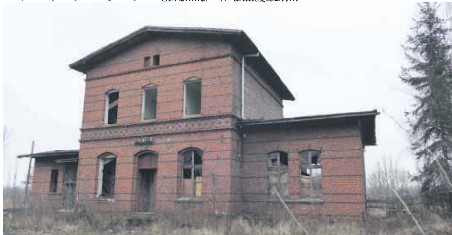
Dawna stacja PKP w Jegłowej jest rujnowana. W ostatnich dniach ktoś zdemontował i ukradł część kamiennych schodów, a wcześniej okna z futrynami
