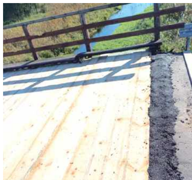
Most w Czernięcinie Poduchownym został doraźnie zabezpieczony, ale czeka go remont
