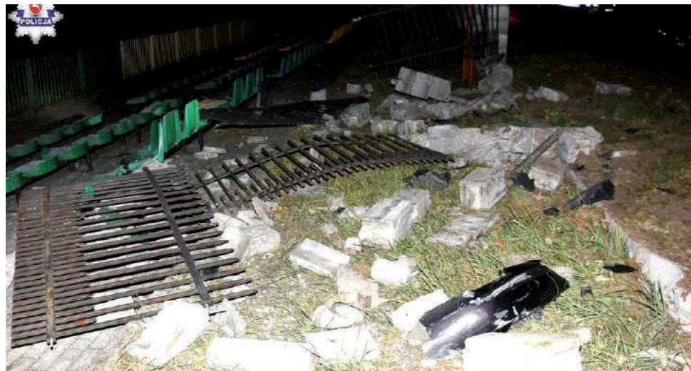
Siła uderzenia była tak duża, że auto uszkodziło metalowe przesła i betonowe elementy płotu (fot.KPP Łuków)
