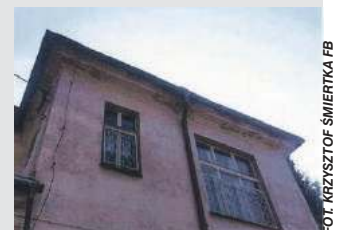
Stan budynku pozostawia wiele do życzenia
