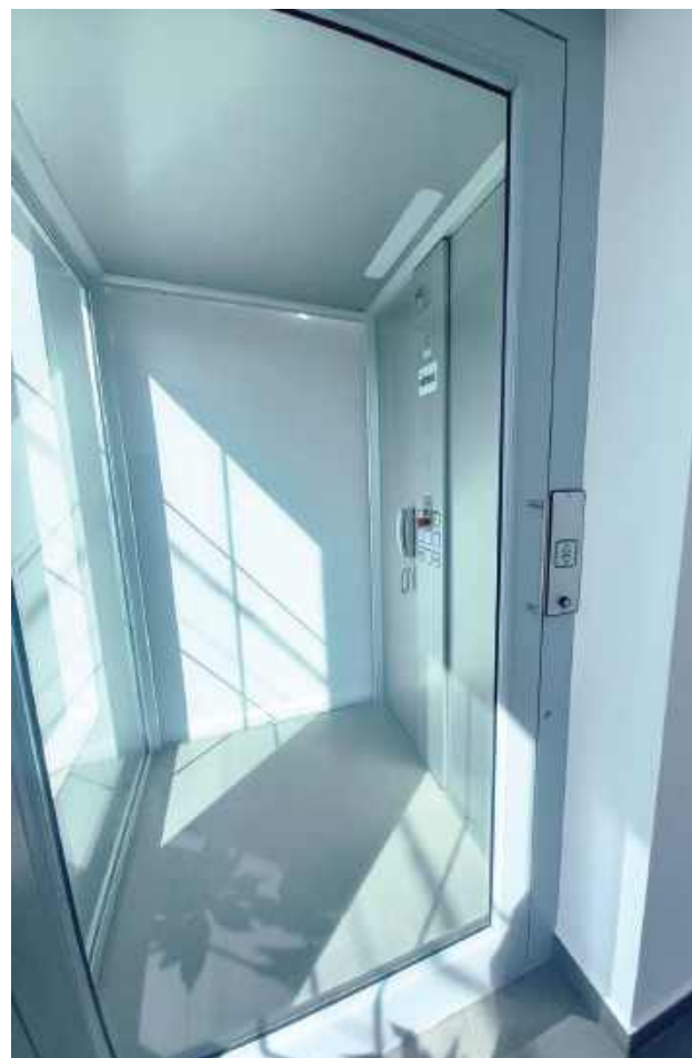
W budynku zamontowano windę
