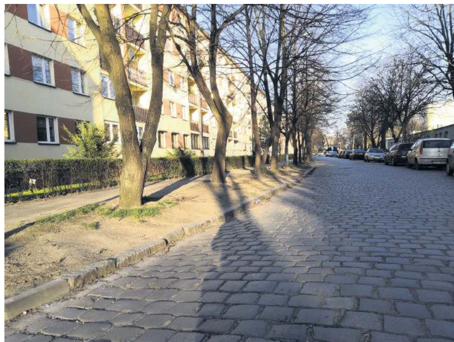
Aby remont ul. Staszica mógł być przeprowadzony, jest potrzebna jeszcze zgoda dwóch lokatorów, którzy są współwłaścicielami chodnika
