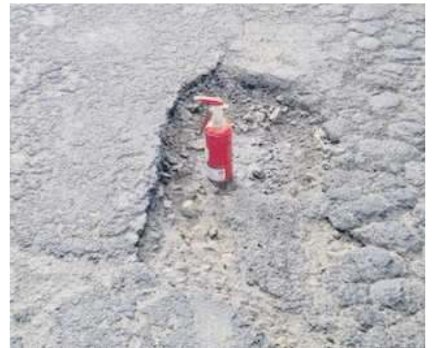
Mieszkaniec zwrócił uwagę na potężną dziurę w drodze powiatowej w Chociwelu. Foto: Czytelnik
