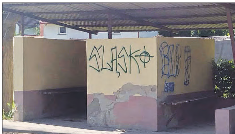
Jeden ze zniszczonych przystanków w Łące i Moszczance
