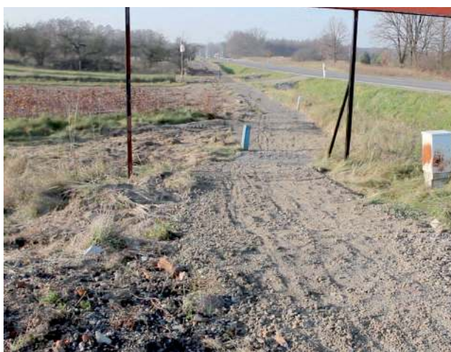
- Trudno poruszać się pieszo po czymś takim, nie wspominając o wózkach z dziećmi i rowerach. Ta namiastka wykonana tuż przed wyborami ledwo nadaje się do poruszania pieszo – mówi pan Edward z Zosina
