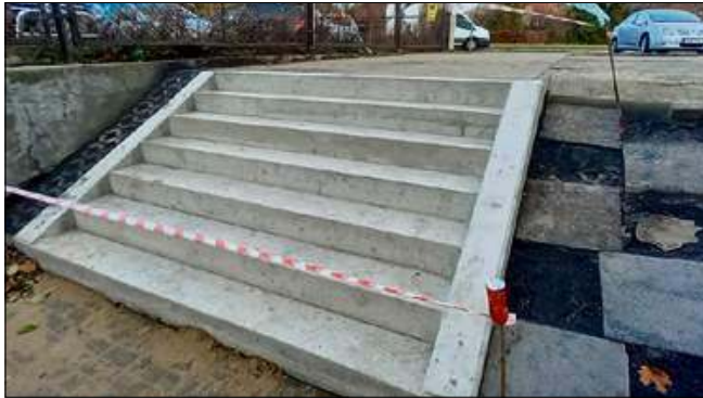
Nowe schody nie mają poręczy.
