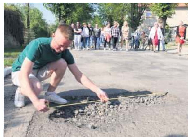
Dziury w nawierzchni drogi powiatowej w Bierzynie mają ponad metr szerokości. Są też bardzo głębokie
