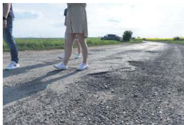
Droga powiatowa Bierzyn-Warkocz jest pełna dziur i wyrw, a pobocza zostały zdarte
