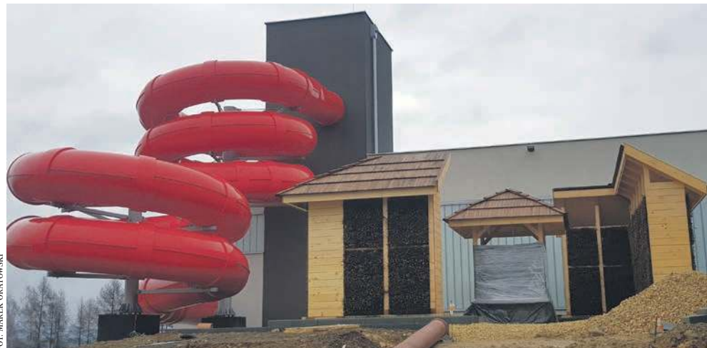
Tężnia w Libiążu stoi przy basenie budowanym na osiedlu Flagówka i zostanie uruchomiona razem z nim pod koniec kwietnia
