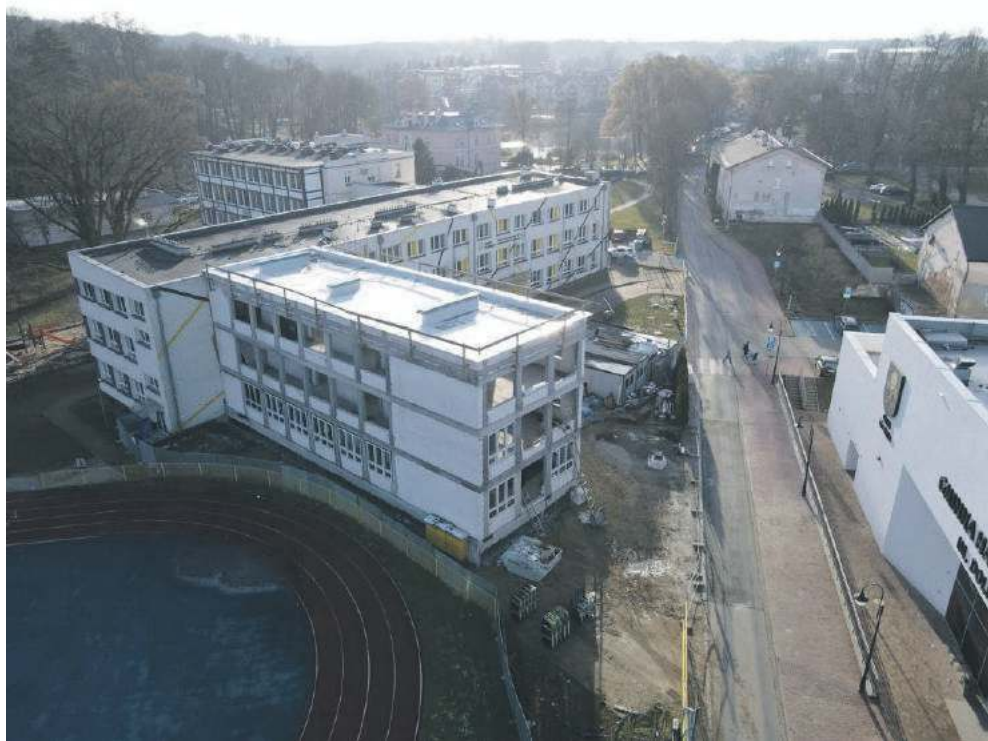
Dzisiaj już wiemy, że nowe skrzydło nie zostało spasowane ze starym budynkiem. Czy to błąd projektanta lub wykonawcy, czy może stary budynek osiadł?
