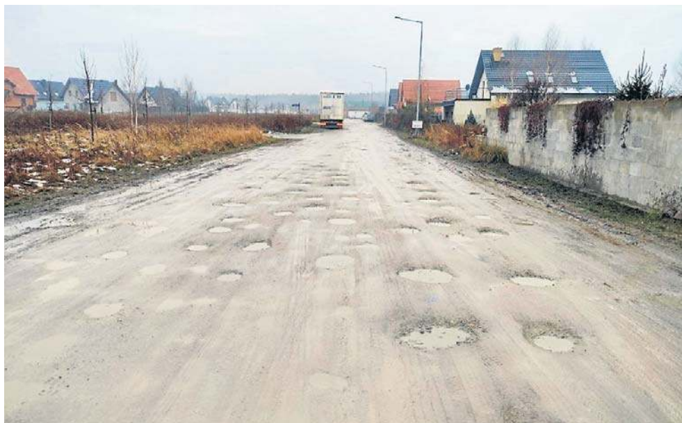
Kolej przez parę lat modernizowała linię kolejową i budowała przystanki. Tymczasem gminie zabrakło czasu, by zbudować 500 m asfaltowej drogi, by ludzie mogli wygodnie dojść do przystanku w ich wsi
