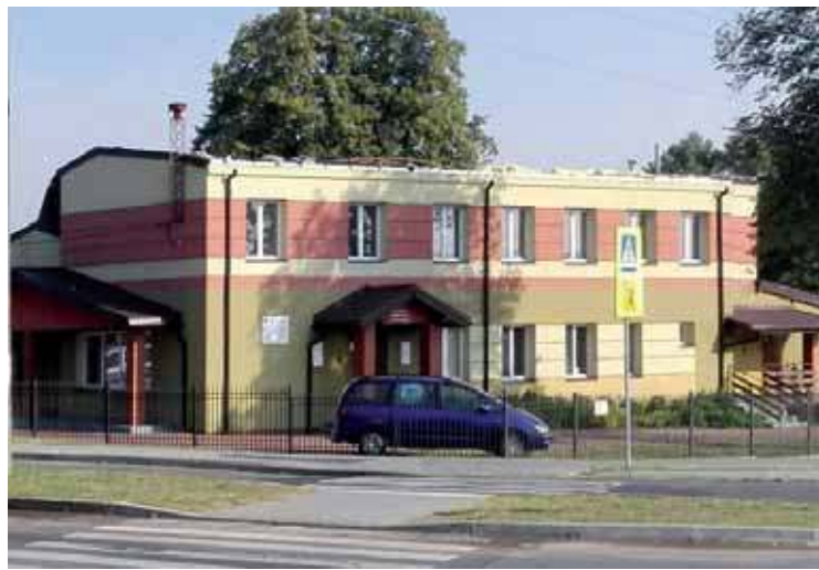
Uszkodzony dach świetlicy ma zostać naprawiony
