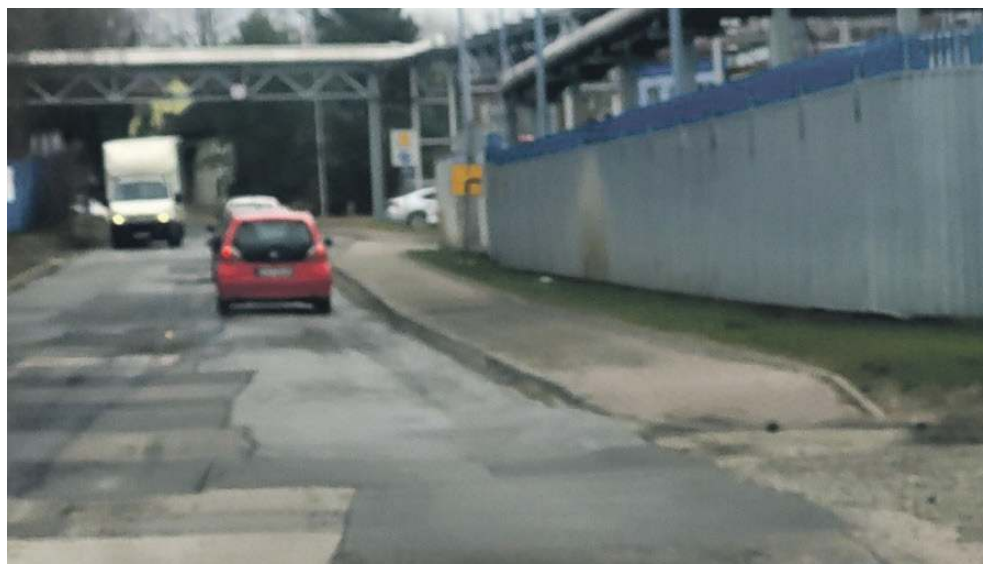
Ul. Pułaskiego w Trzebini, prowadząca w kierunku rafineryjnych torów, jest jak sito. W weekend dziury zostały wypełnione kamieniem
