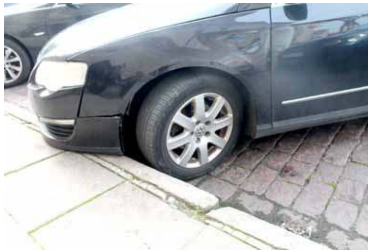
Zderzak uległ zniszczeniu z powodu zbyt wysokiego krawężnika kierowca.
