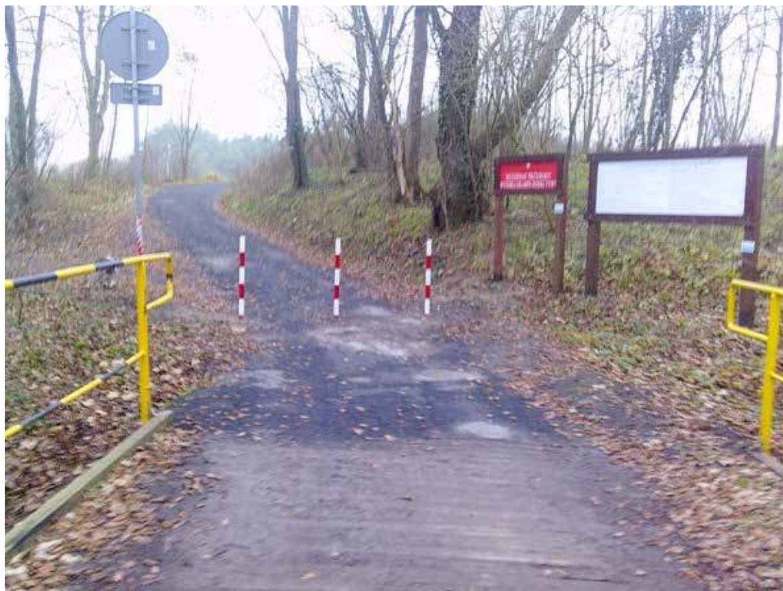
Droga z ronda do Żórawek przez ten mostek została poprawiona. Ale choć jest tablica wskazująca kierunek z ronda, mostek został opalikowany Kiedy zostanie naprawiony wie tylko...
