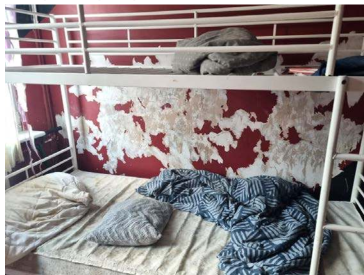
W sypialni lokatorzy zostawili po sobie obdrapane ściany i brudną pościel.
