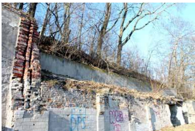
Odpadające fragmenty i graffiti to częste oblicze dewastacji i degradacji naszych murów
