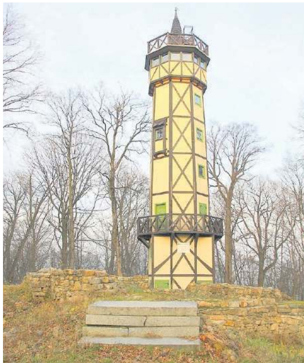
Budowa tego obiektu kosztowała około 560 tys. złotych, a remont będzie kosztował 240 tys. zł. Okazuje się, że najprawdopodobniej od początku powstania obiektu nie było kontroli jego stanu technicznego
