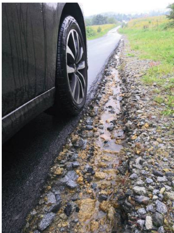
Po ostatnich ulewach podmyte zostało pobocze ulicy Sosnowej w Gęsińcu
