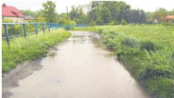
Po opadach deszczu droga w Stanicy przeradza się w koryto potoku. Foto: Jadwiga Świetlik
