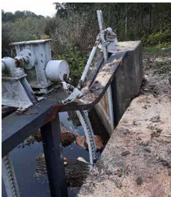
Tak wygląda uszkodzone urządzenie hydrotechniczne na rzece Krapiel
