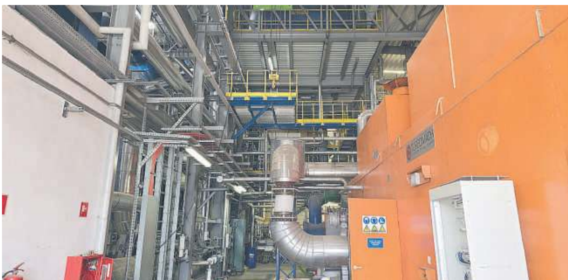
Ta skomplikowana maszyneria to ważna część modernizowanego obiektu
