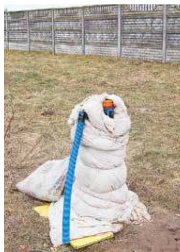
Pompa przy pałacu
