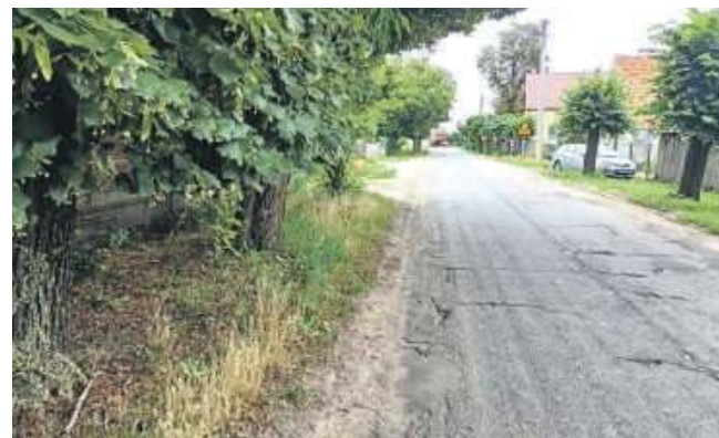
Niebezpieczna droga w Domanowicach
